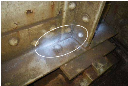
図-1 下フランジ山形鋼コーナー部のき裂
