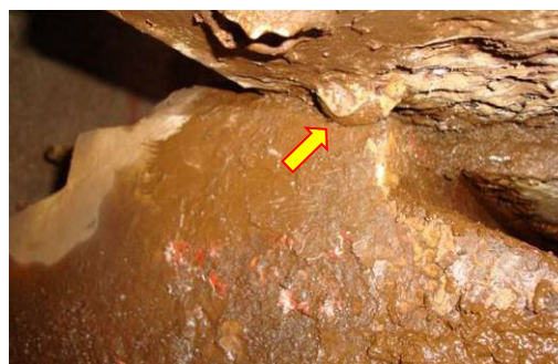
付図3 支承部の接触事例②
